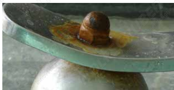
Risultato scelta materiale errata in una piscina
